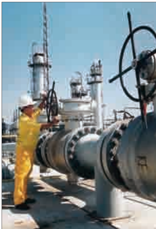
Một đoạn đường ống dẫn khí ở Nhà máy khí Dinh Cố
